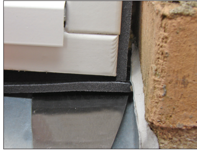
8. Det vågräta fogbandet monteras och trycks ihop med den lodräta biten (se bild 8).
